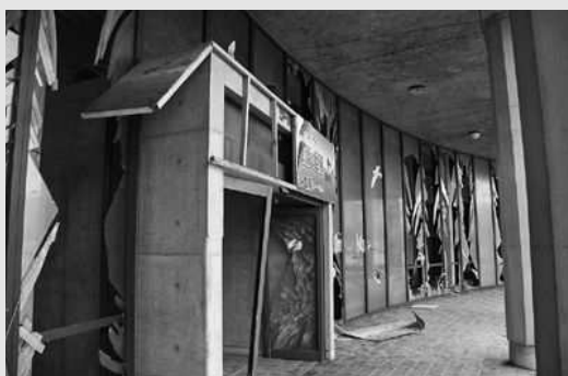
津波が直撃したマリンパル女川のエントランス
